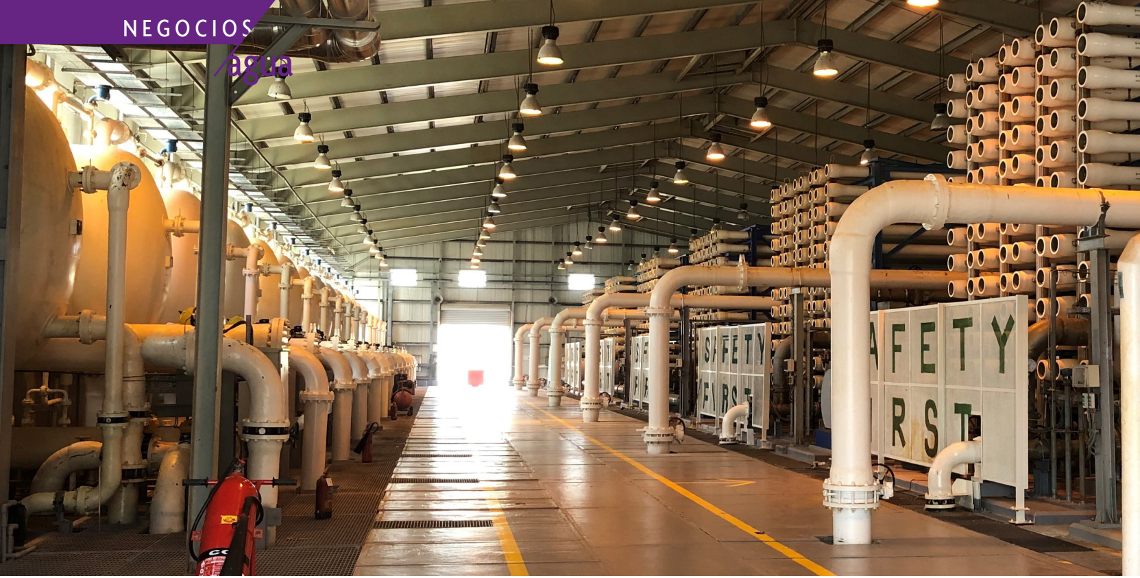
Interior de la planta desaladora del aeropuerto internacional de Jeddah (Arabia Saudí).
